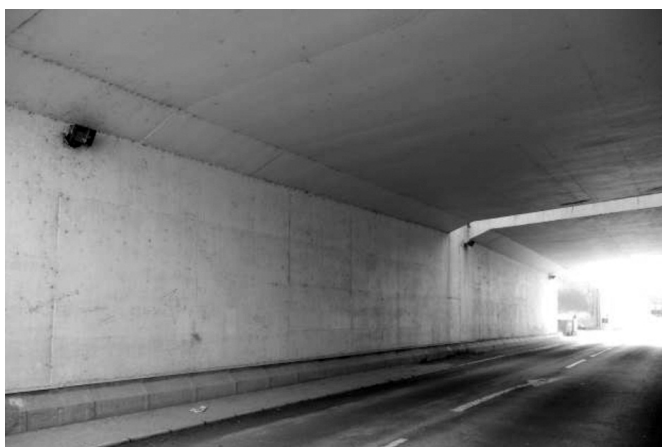
Figure 8 : Piédroits du PI 328 revêtus par un produit à base de styrène-butadiène.
