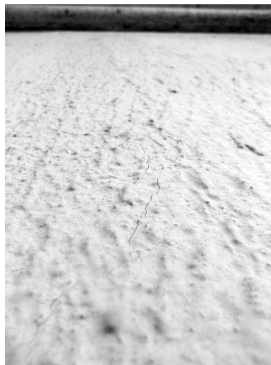
Figure 23 : Fissuration du revêtement du PS 357.
