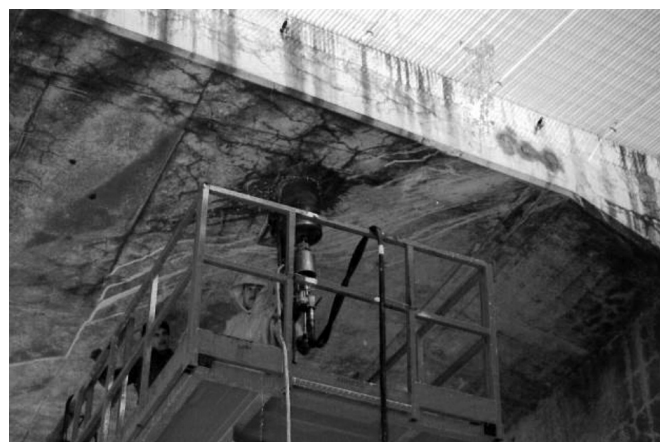
Figure 19 : Prélèvement par carottage (à noter la fissuration horizontale du tablier).
