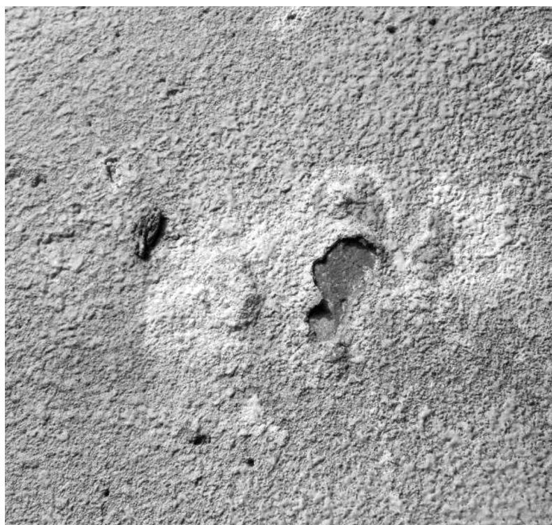
Figure 22 : Cloquage du revêtement du PI 361.
