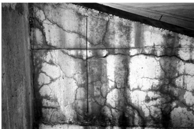
Figure 18 : Tablier fortement faïencé du PI 361.
