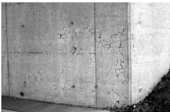
Figure 4 : Faïençage du piédroit et du mur en retour.
