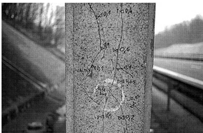
Figure 2 : Faïençage d'une pile de pont.
