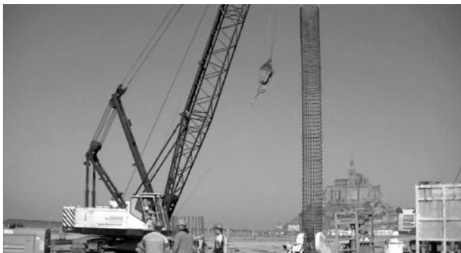
Fig. 5. Mise en place de la cage d'armature du pieu, après tubage et forage (juillet 2012). Setting up of the reinforcement cage of the pile, after boring and setting up of the tube (July 2012)
