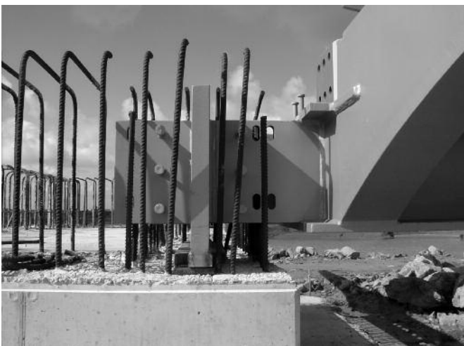
Fig. 13. Détail d'un encastrement de la culée sud (automne 2012). Detail of a built-in system, abutment south (automne 2012).
