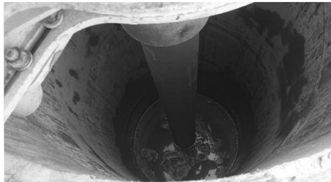
Fig. 8. Poteau dans le tubage, en attente de la prise du béton du pieu, 7m sous le niveau du terrain naturel (juillet 2012). Steel column in the tube, waiting for the hardening of the concrete of the pile, 7m below the ground level (July 2012)
