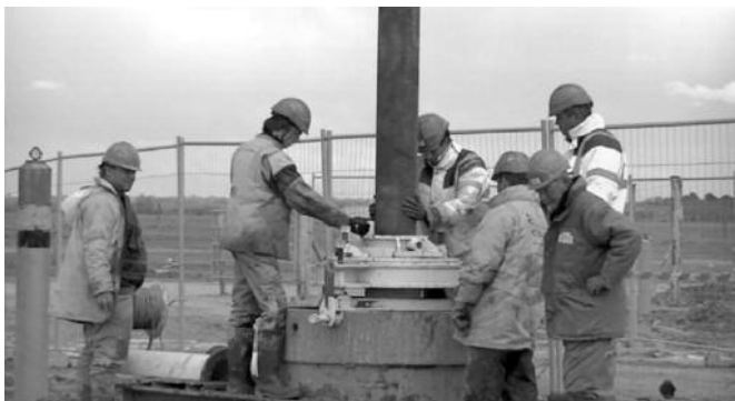
Fig. 7. Mise en place d'un poteau par les ouvriers, avec l'aide du dispositif de centrage, juste après le coulage du béton dans le pieu (juillet 2012). Setting up of the steel column by the workers, just after pouring the concrete in the pile (July 2012)
