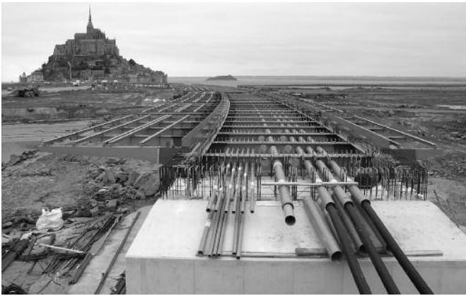
Fig. 11. Culée sud avant bétonnage de la partie supérieure (automne 2012). Abutment South before concreting of the higher part, width 6,50m (Autumn 2012).
