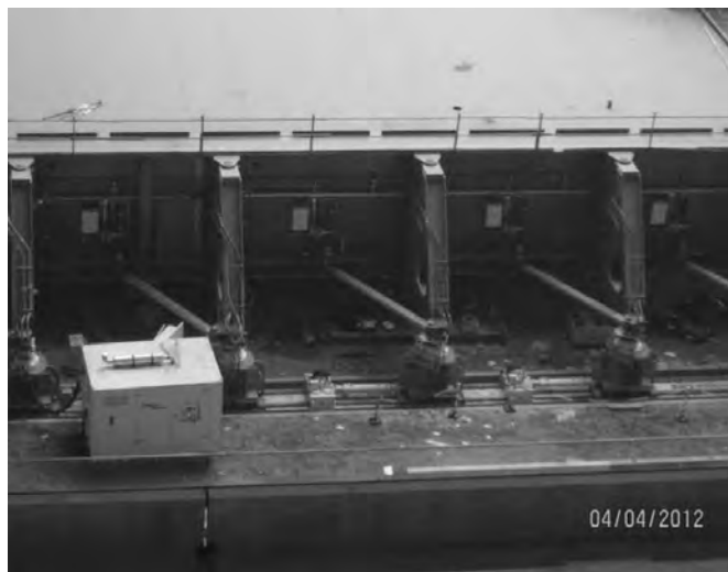
Groupe de puissance lors de la première installation.
